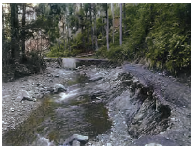
国有林手前民地林道（路体流失）
